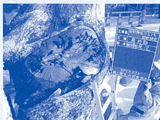
モルタル処置後の腐朽の進行が目立つ
